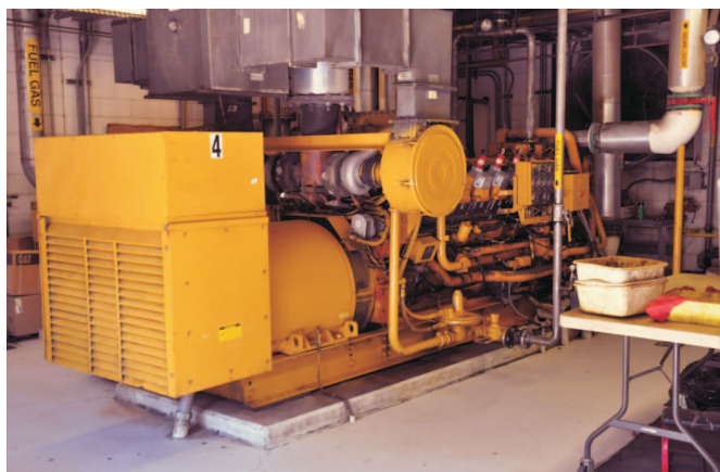
Fot. 1. Silnik firmy Caterpillar zasilany gazem składowiskowym (źródło: fotografia własna)
