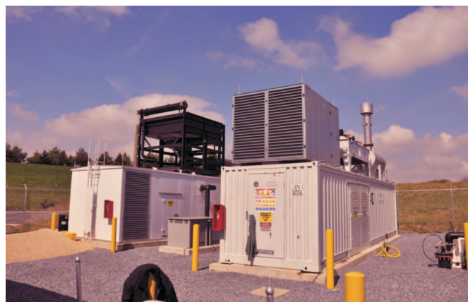
Fot. 2. Układy CHP na składowisku odpadów komunalnych (źródło: fotografia własna)
