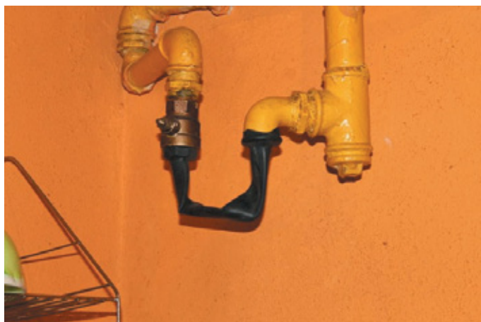
Rys. 2. Fragment instalacji ze zdemontowanym gazomierzem. Dzięki uprzejmości KMP w Legnicy
